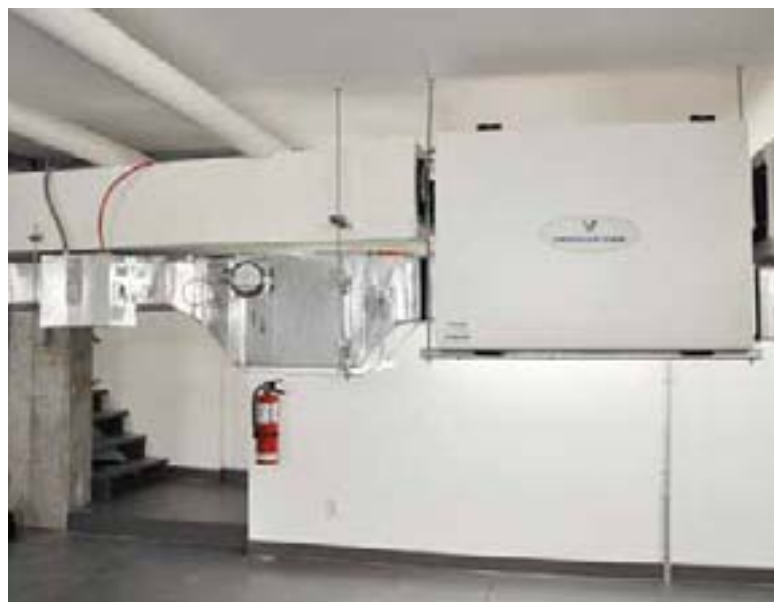
Le VRC Venmar distribue les débits d'air requis par la norme Novoclimat dans chaque logement. L'air vicié des logements n'est pas recirculé afin de ne pas propager les odeurs de cuisson. Un chauffe-conduit électrique préchauffe l'air de ventilation si nécessaire et évite les cycles de dégivrage.
